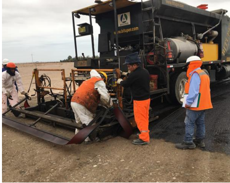
Figura 26. Aplicación y calibración de mezcladora para mortero asfáltico en tramo de prueba.
