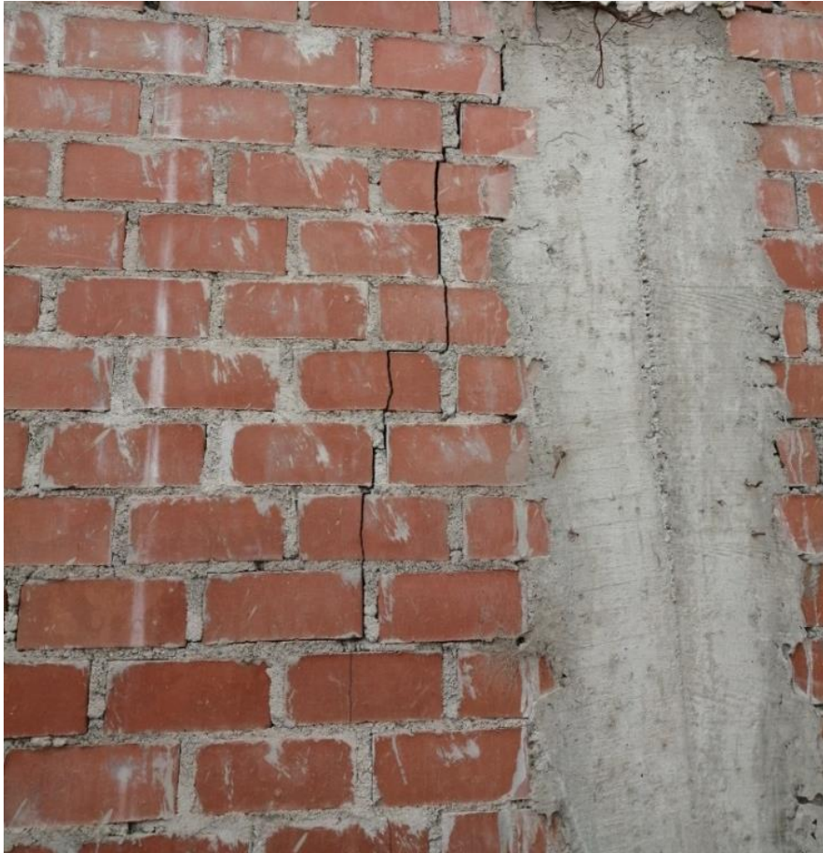
Figura 52. Vivienda con muros agrietados
