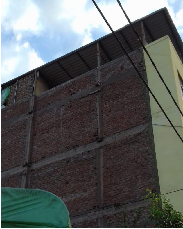
Figura 3. Muros de albañilería altos sin vigueta de amarre.
