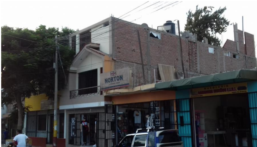
Figura 1. Mala aplicación de ladrillos pandereta en el 2° y 3° nivel.
