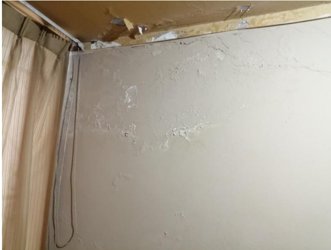
Figura 38. Falla por corte en muro y presencia de humedad
