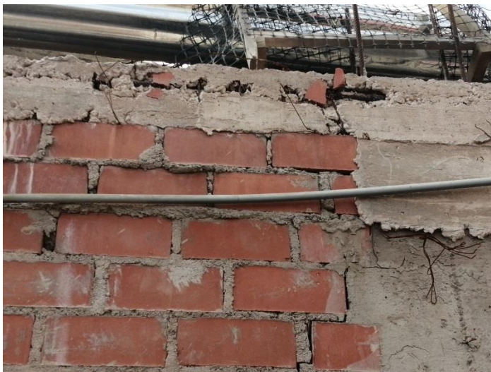
Figura 51. Vivienda con aceros expuestos por cangrejeras
