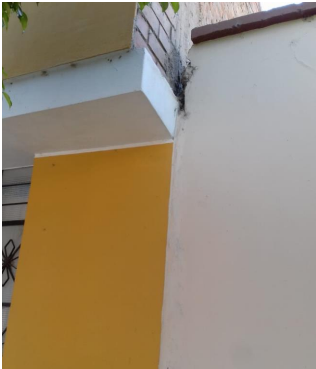
Figura 4. Falta de junta sísmica en viviendas de distintos propietarios.
