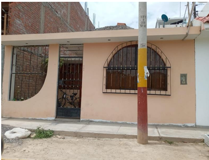
Figura 50. Vivienda sin junta sísmica
