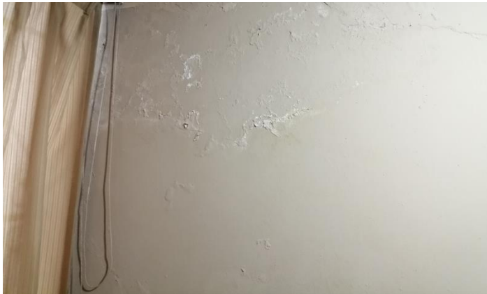
Figura 53. Vivienda con eflorescencia en muros
