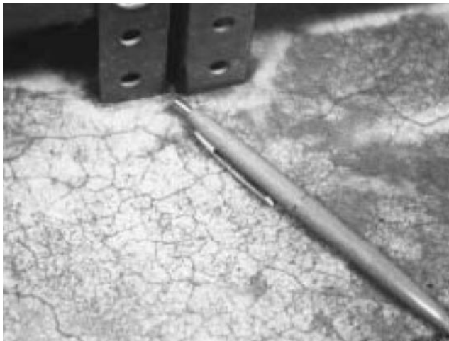
Figura 7. Resquebrajamiento del concreto
