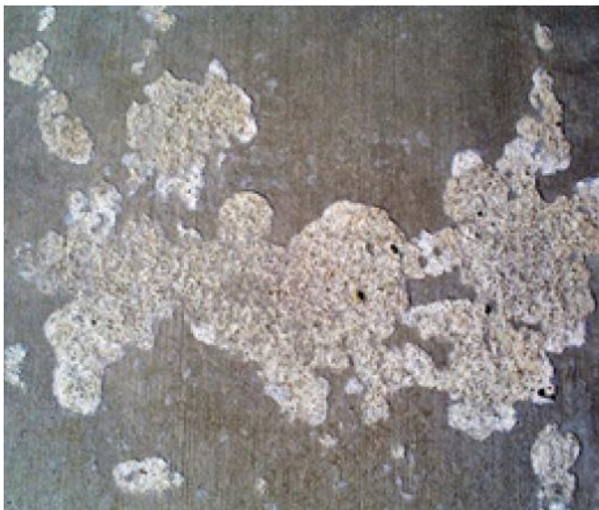
Figura 4. Escamado de concreto
