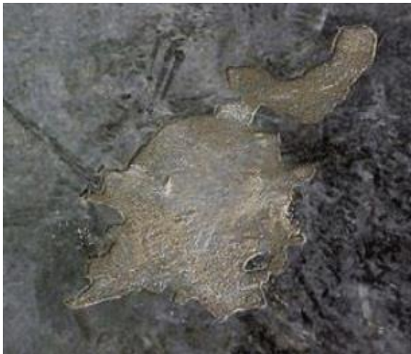
Figura 3. Delaminación del concreto
