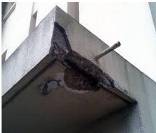
Figura 5. Descascarado en la edificación
