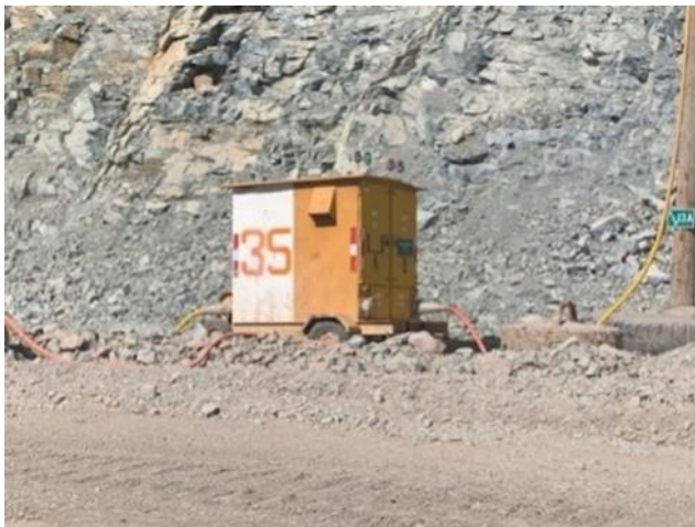
Figura 40. Imagen del switch house Nro. 35 de marca LinePower
