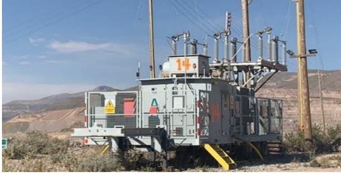
Figura 44. Imagen de la subestación Nro. 14 de mina Cuajone
