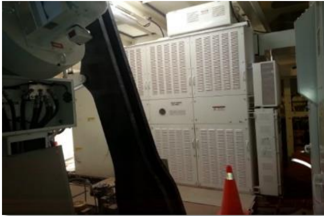
Figura 22. Imagen del transformador principal 2500 kVA Pala 3
