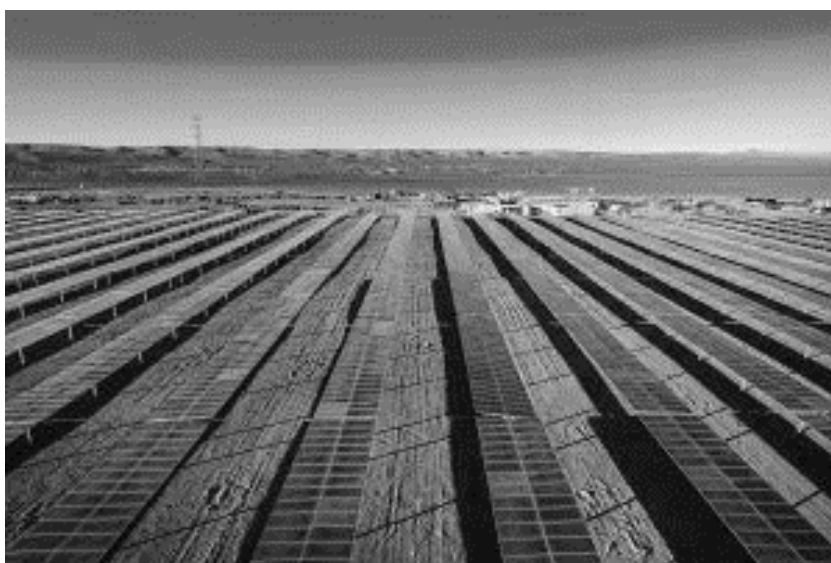
Figura 3. Planta solar Rubí, construida por ENEL
