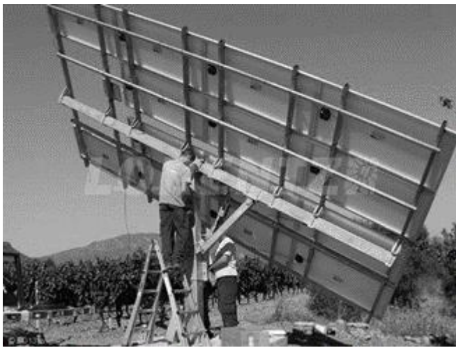
Figura 46. Instalación de un seguidor solar
