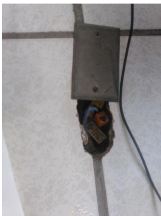
Figura 3. Tapas ciegas en mal estado de puntos de data en piso clausurados
