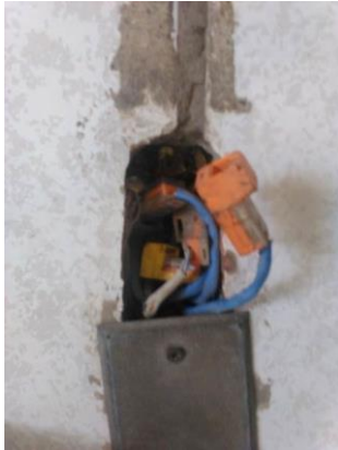
Figura 4. Terminales de data deficientes y mal estado.
