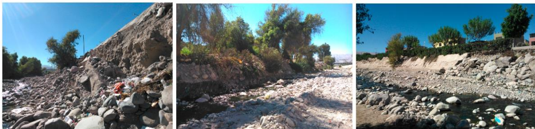
Figura 22. Destrucción, socavamiento, colapso de defensa ribereña y áreas de cultivo.
