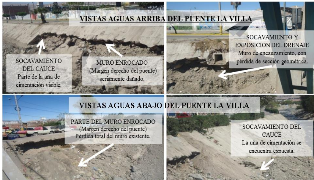
Figura 5. Fotos de la socavación y erosión en el río Moquegua, febrero 2015.
