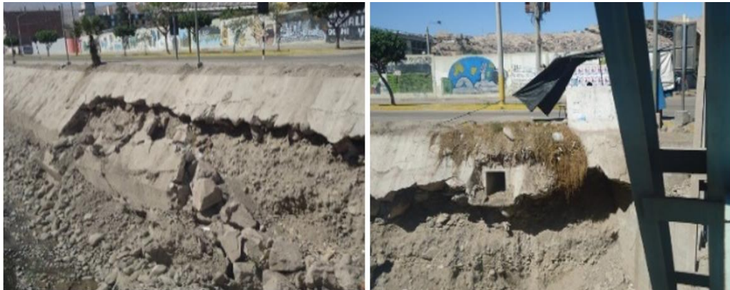
Figura 27. Erosión fluvial muy crítica en margen izquierda del río Tumilaca.
