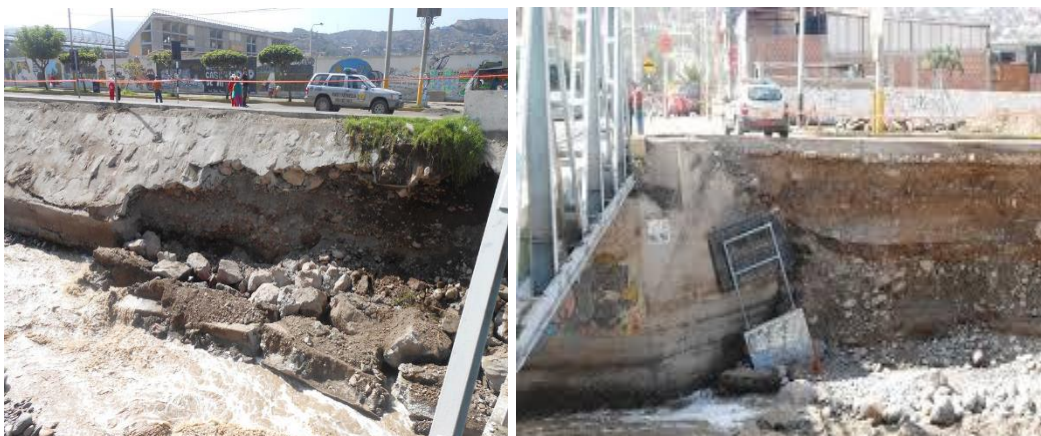
Figura 14. Acción erosiva en base del muro sostenimiento aguas arriba puente Villa (derecha), Condiciones expuesta vulnerable muro encauzamiento aguas abajo puente “La Villa”, domingo 15 de febrero del 2015 (izquierda).
