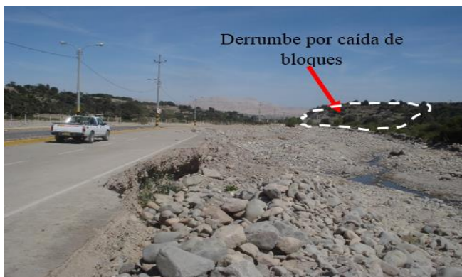
Figura 26. Derrumbe en afloramiento rocoso, margen derecho río Tumilaca.
