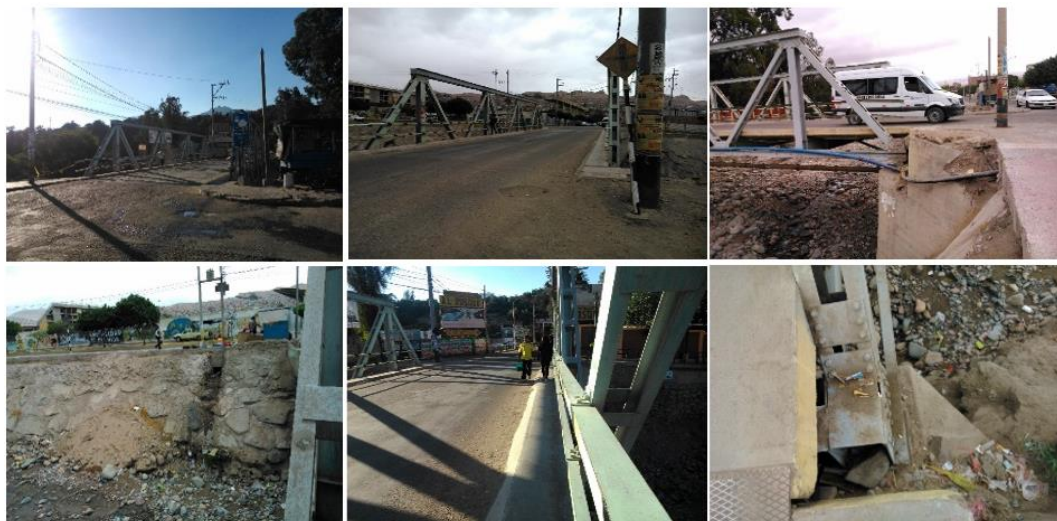
Figura 8. Fotografía de condición deteriorada de elementos en puente "La Villa".
