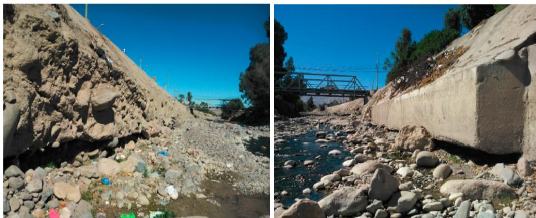
Figura 28. Evidencias de socavamiento ocasionado por los agentes hidrológicos.
