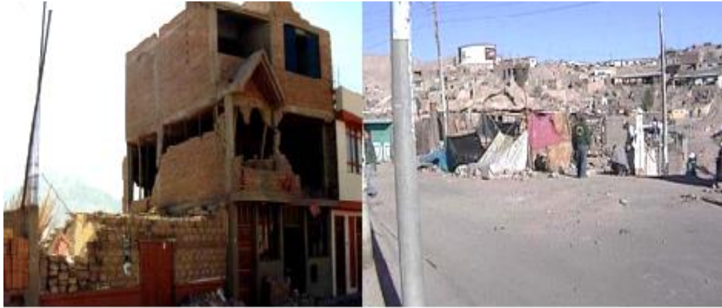
Figura 12. Fotografías de daños ocasionados en terremoto del 23/07/2001.
