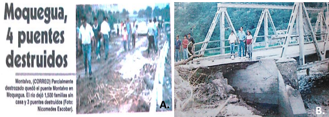
Figura 13. A. Efectos sobre puentes por fenómeno del niño (martes 04 de marzo del 1997), B. Condiciones expuesta vulnerable puente “La Villa”, miércoles 05 de marzo del 1997.
