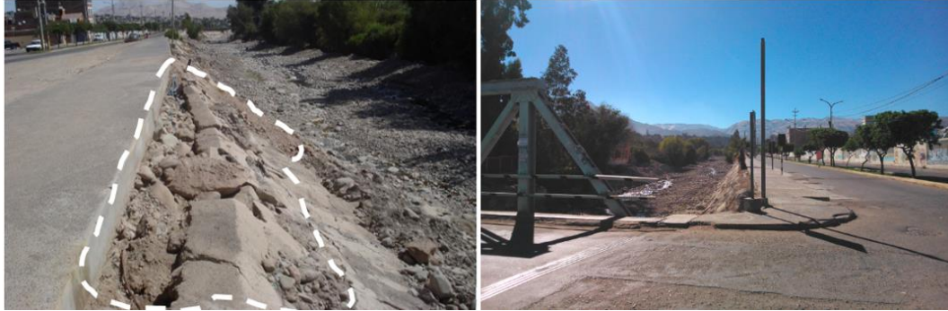
Figura 29. Asentamiento del talud de sostenimiento de la vía.
